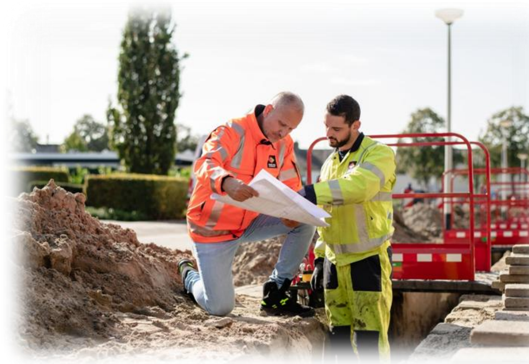
Netverzwaring door netbeheerder Enexis, Bron: Enexis .
