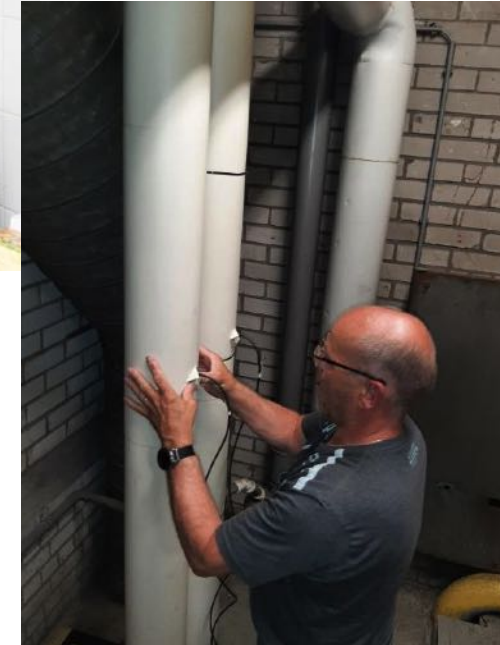
sensoren op de installaties
